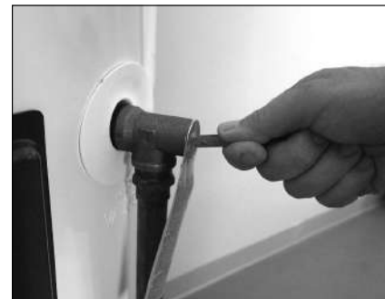
Figure 38 - Soupape de décharge DST
