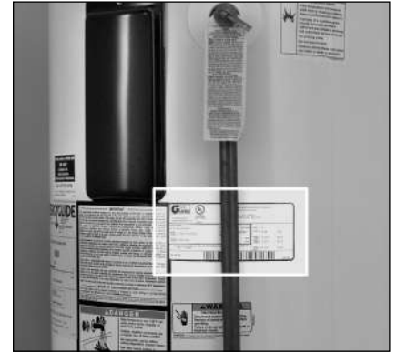
Figure 18 - Les exigences électriques du chauffe-eau peuvent être déterminées à partir de la plaque signalétique.
